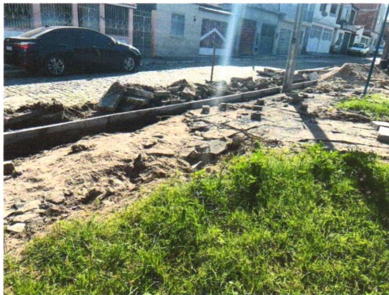
Foto 03 - ASSENTAMENTO DE GUIA (MEIO-FIO) EM TRECHO RETO, CONFECCIONADA EM CONCRETO PRÉ-FABRICADO, DIMENSÕES 100X15X13X20 CM (COMPRIMENTO X BASE INFERIOR X BASE SUPERIOR X ALTURA), PARA URBANIZAÇÃO INTERNA DE EMPREENHIMENTOS. AF_06/2016_P
