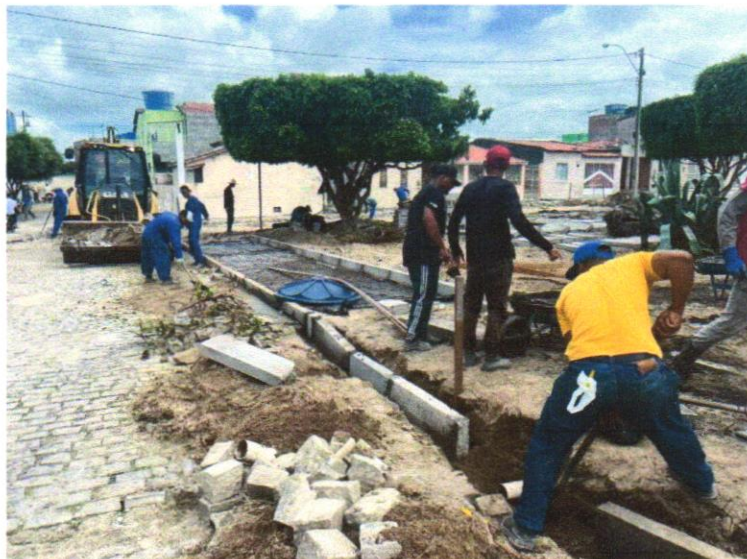
Foto 04 - ASSENTAMENTO DE GUIA (MEIO-FIO) EM TRECHO RETO, CONFECCIONADA EM CONCRETO PRÉ-FABRICADO, DIMENSÕES 100X15X13X20 CM (COMPRIMENTO X BASE INFERIOR X BASE SUPERIOR X ALTURA), PARA URBANIZAÇÃO INTERNA DE EMPREENHIMENTOS. AF_06/2016_P
